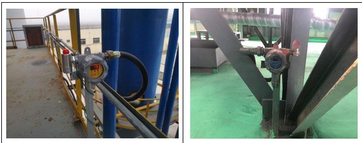
图 4.2-4 厂区报警及监控系统
