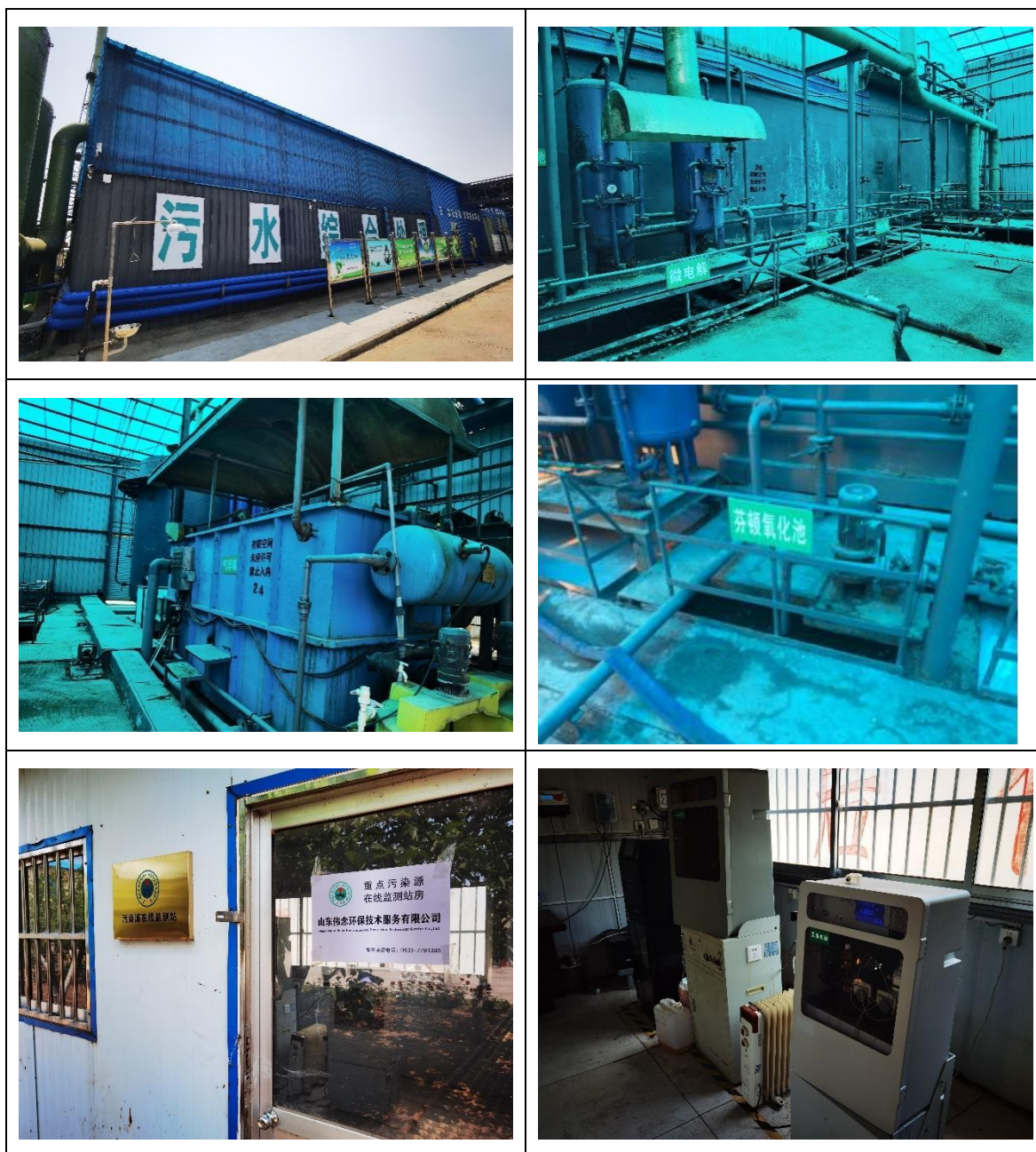
图 4.1-2 厂区污水处理设施
