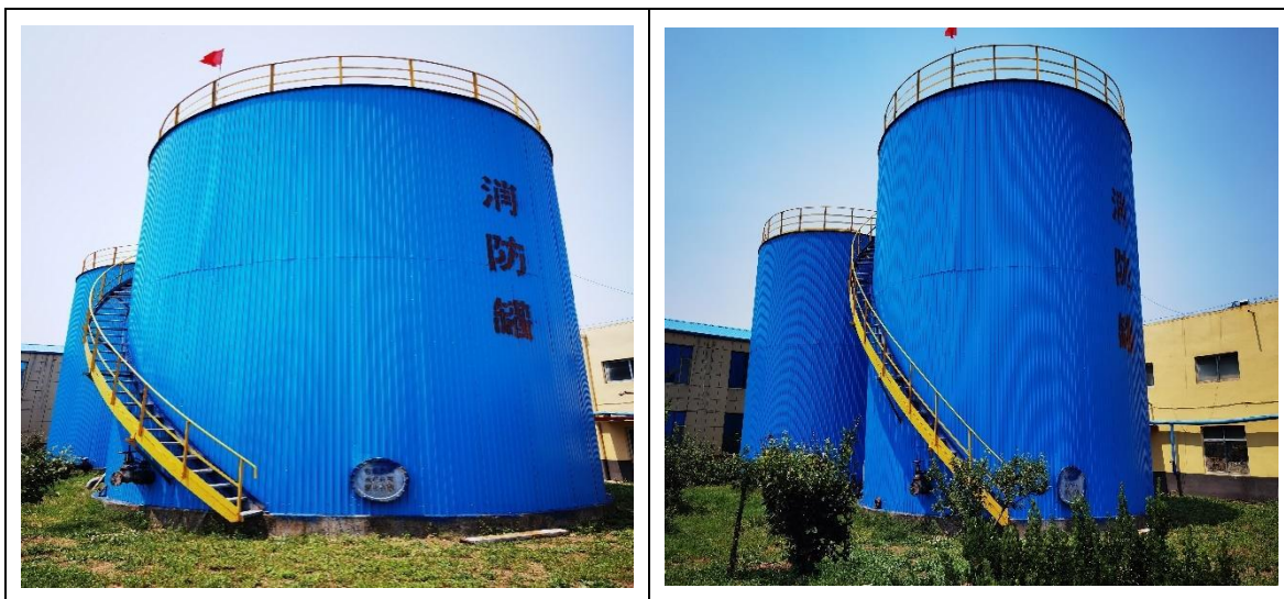
图 4.2-3 厂区消防应急设施
