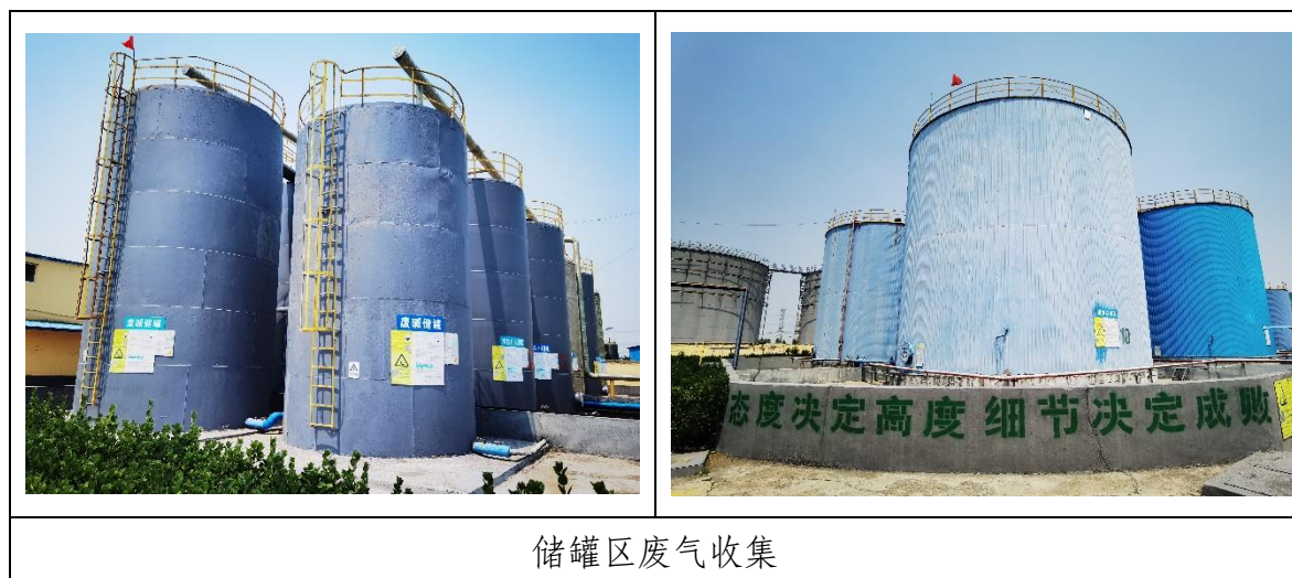
图 4.1-4 项目废气治理设施
