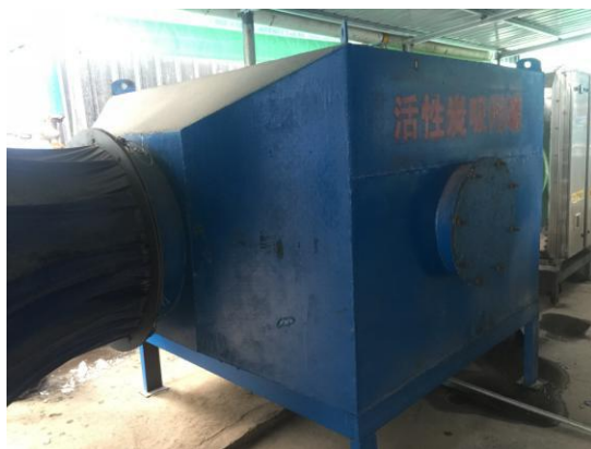
污水处理站活性炭吸附装置
