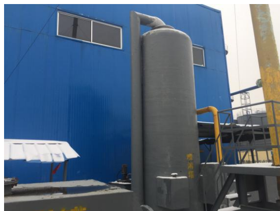
精制车间喷淋装置
