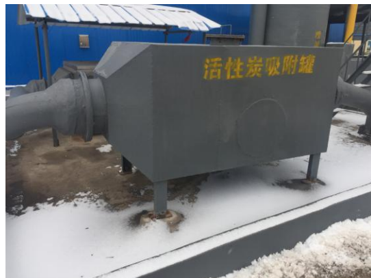
精制车间活性炭吸附装置
