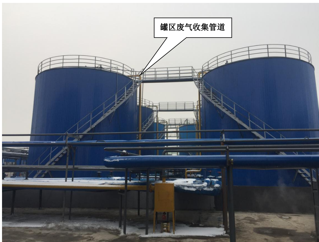
罐区废气收集管道
