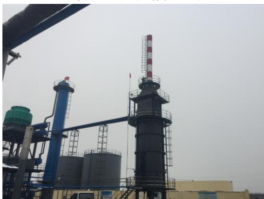
加热炉排气筒及平台
