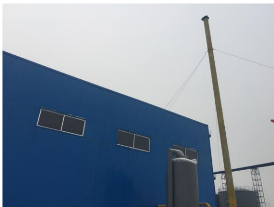
精制车间排气筒
