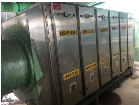
污水处理站光解装置
