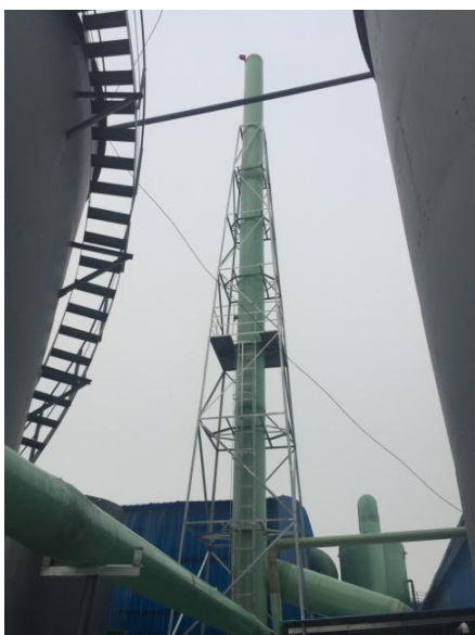
污水处理站排气筒及平台
